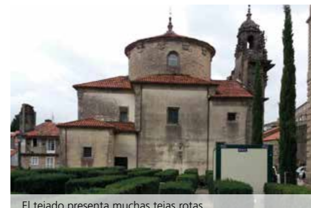
El tejado presenta muchas tejas rotas, con peligro de desprendimiento
