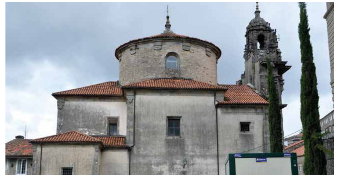
Las rejas de las ventanas de las fachadas norte y sur están oxidadas
