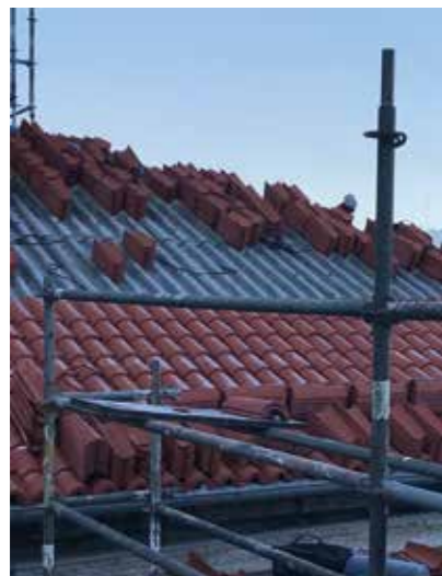
La teja estaba en muy mal estado
