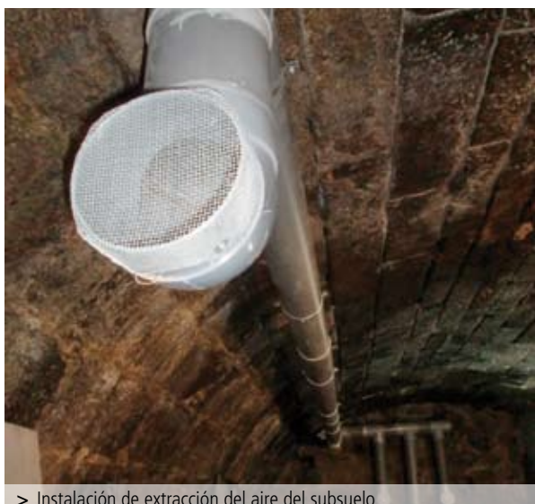
> Instalación de extracción del aire del subsuelo
