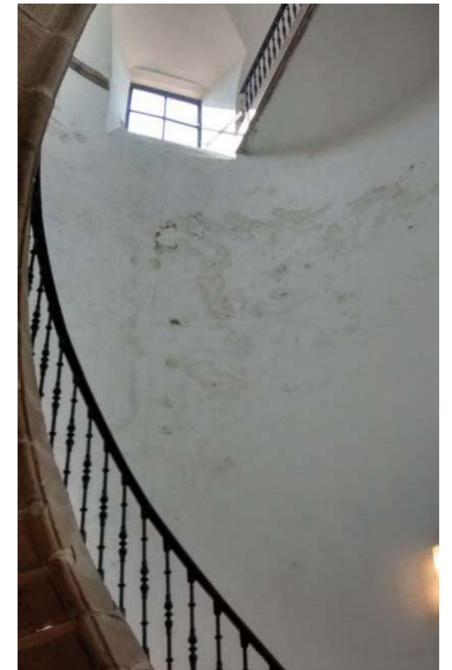
La escalera helicoidal del Museo do Pobo Galego está muy afectada por las humedades
