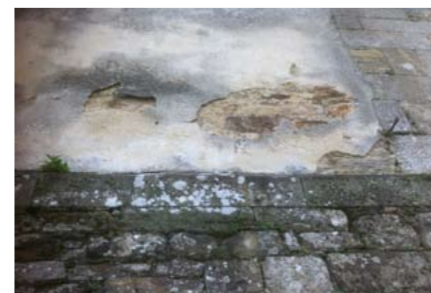
Se sanearán las fachadas, en las que se aprecian los efectos de la humedad
