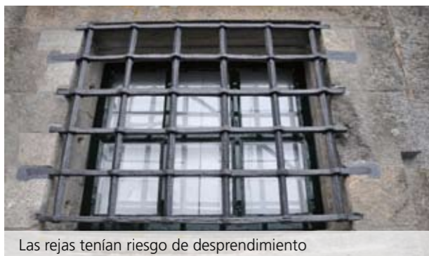
El enrejado de la fachada principal es el que se encuentra en peor estado
